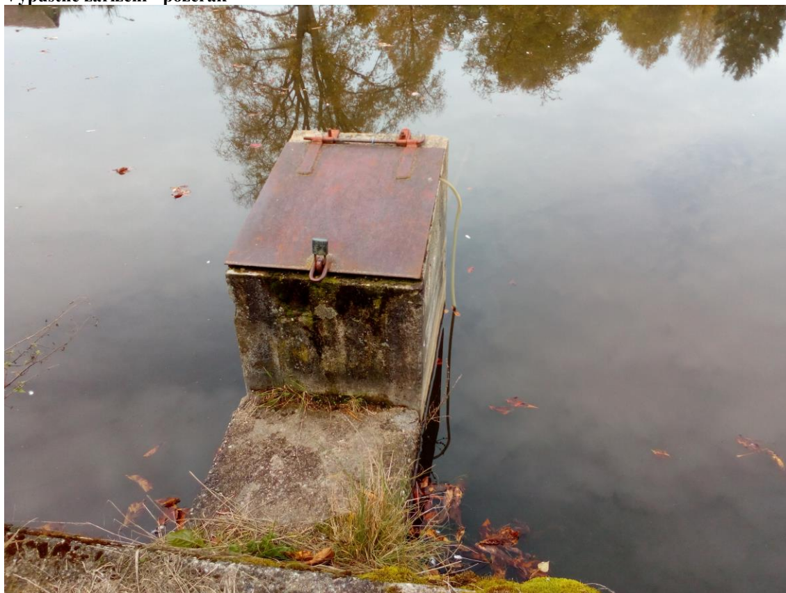
Výpustné zařízení - požerák
